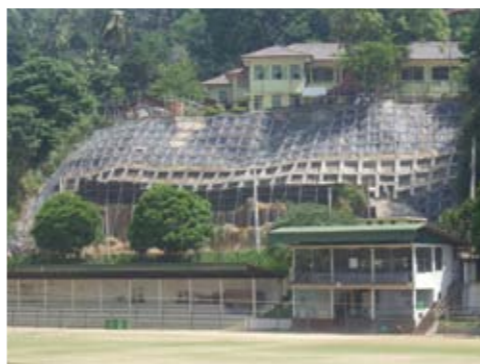
現在施工中の傾斜地の全景。スリランカには急速な開発、脆弱な地質特性、急峻な地形条件などのため地すべりが起りやすい土地が多く、対策が待たれる
