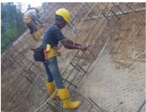
傾斜地にユニット式金網型枠を設置する現地スタッフ。今回の事業では技術適用調査のほか、セミナーや設計・施工マニュアルの紹介なども行われている
